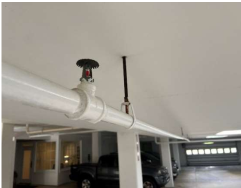
Fire suppression pipes
