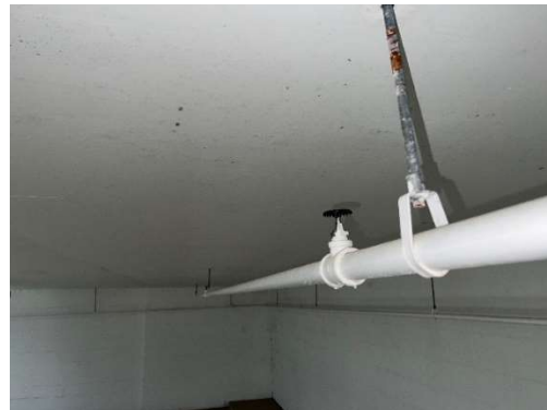
Fire suppression pipes
